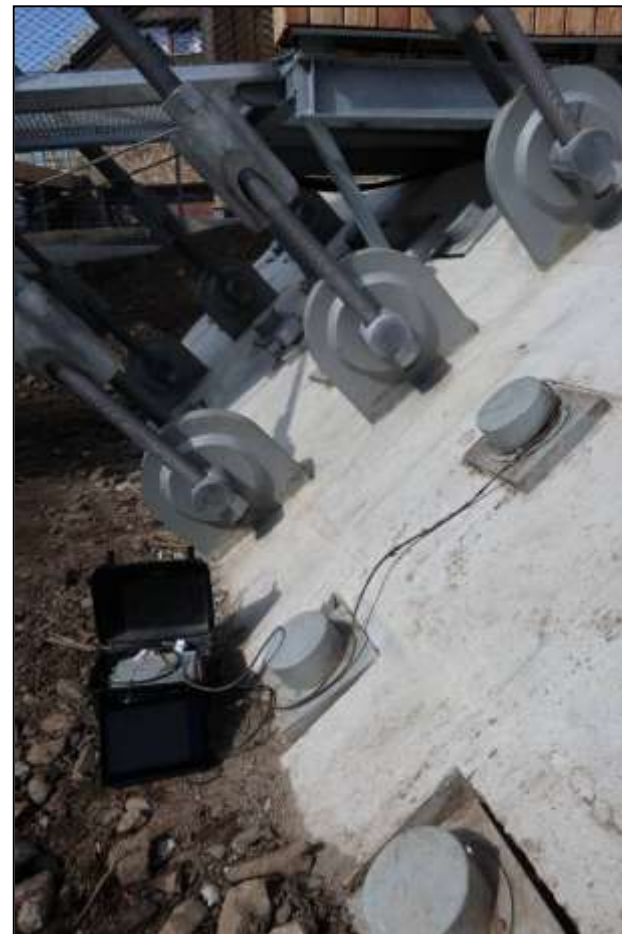
Obr. 2: Měřicí jednotka připojená ke snímačům
