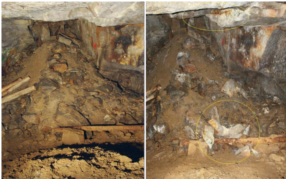
Obr. 4 Místo dopadu uvolněných bloků horniny, vlevo situace před opadem, vpravo po opadu horniny ze stropu (foto: Lednická)
