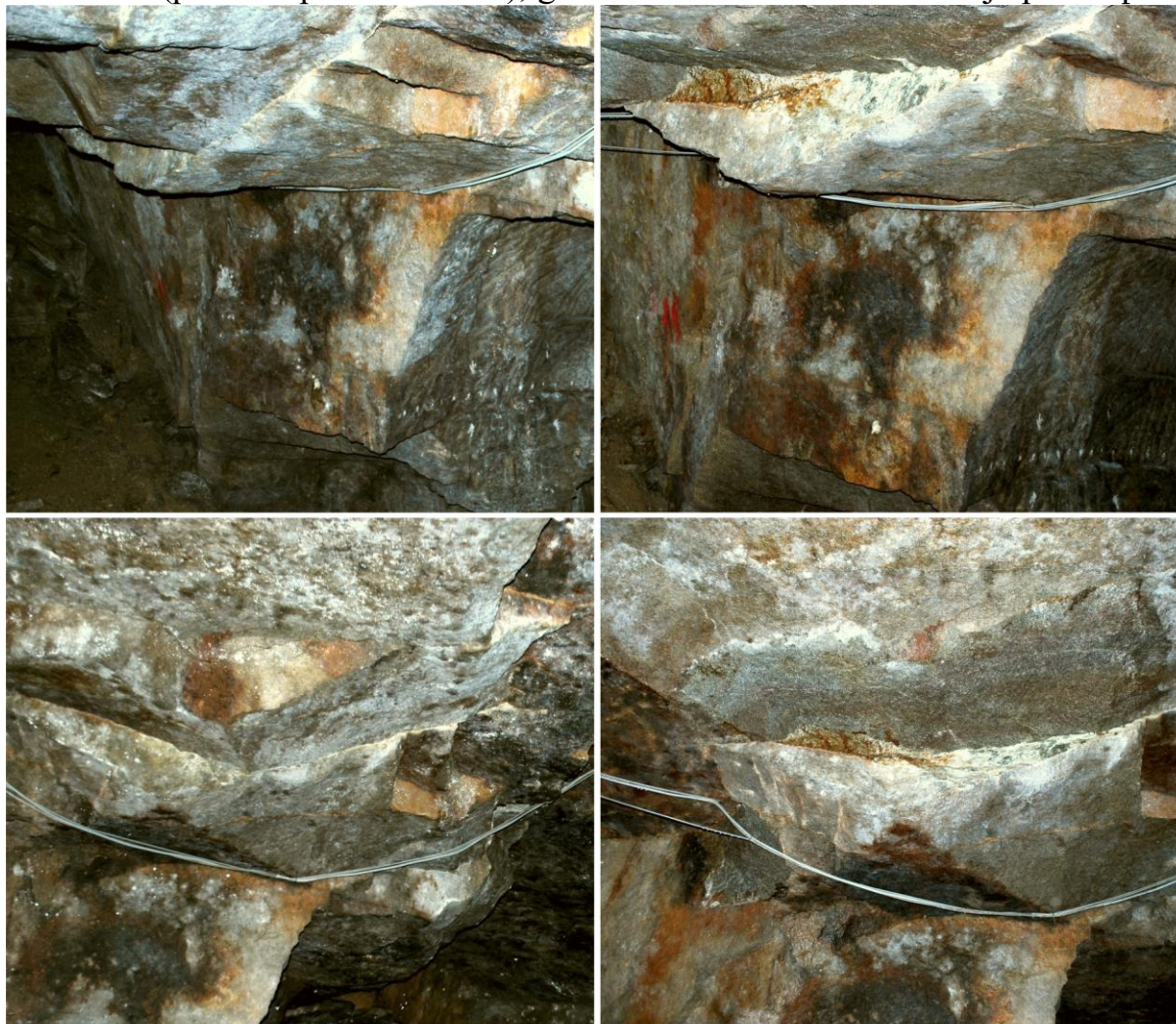
Obr. 3 Fotografie znázorňující situaci před (vlevo) a po vzniku opadu horniny (vpravo), jsou zřetelně vidět odlučné plochy, podél nichž se horninový blok uvolnil (foto: Lednická)
