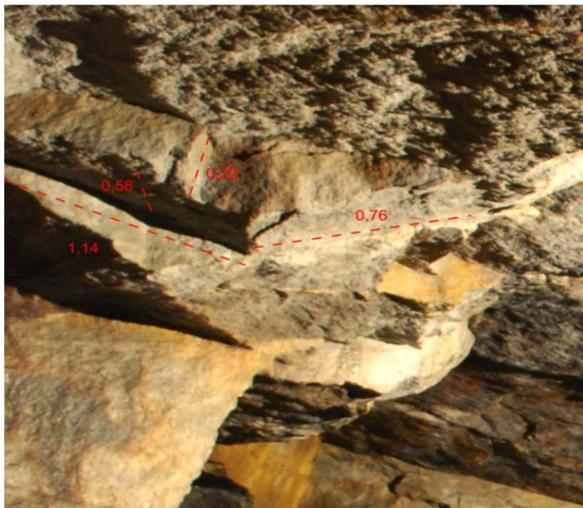
Obr. 2 Situace stropní části v komoře K1, v níž došlo k opadu horninového bloku, s naznačením rozměru opadu v metrech (foto: Lednická)
