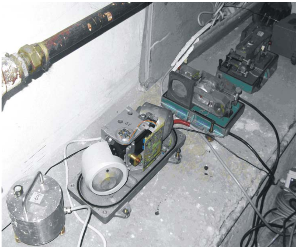
Obr. 5 Instalace seizmometrů na experimentální stanici Doubrava v OKR. Vlevo senzor Vigeo kontrolní aparatury Vistec GAIA
