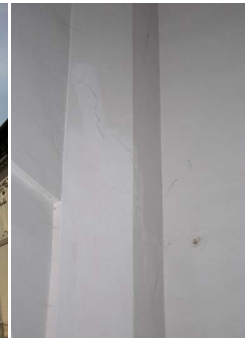
Obr. 2 Stávající praskliny ve zdivu kostela
