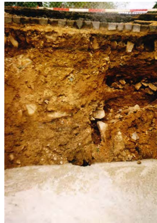
Obr. 1 Zatržení a rozvolnění stěny propadliny u silnice I/18
